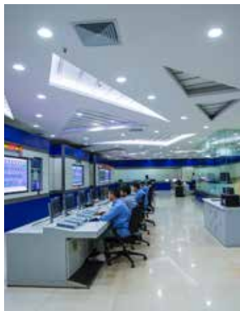
位于印度泰米尔纳德邦南部古德洛尔的古德洛尔燃煤电站运行控制室。
